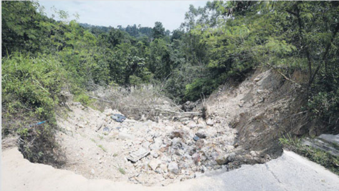
Antara kesan tanah runtuh akibat hakisan yang membentuk cerunan bahaya.
